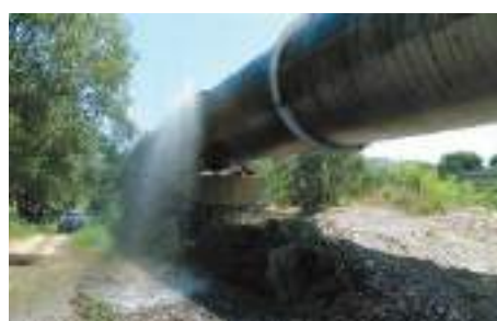
Perdita localizzata della condotta (Fonte: web)
