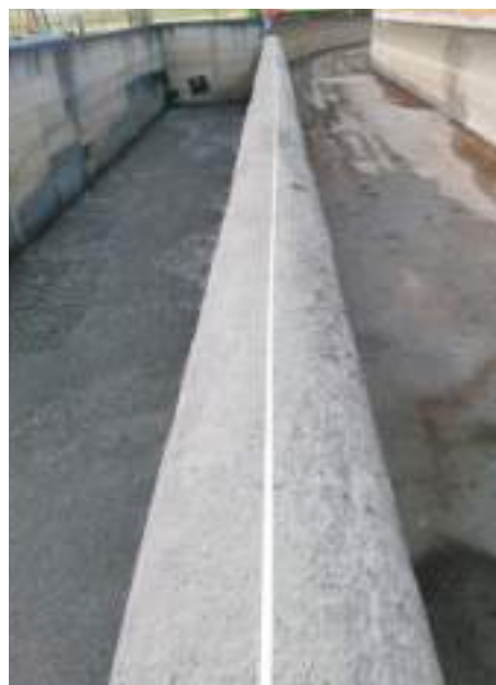
Manufatto di sfioro del Canale Adduttore del Tavoliere in corrispondenza dell'arrivo a Vasca Tavoliere (Fonte: relazione progettuale)
