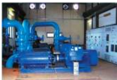
Impianto di sollevamento acque dall'invaso Garcia verso il potabilizzatore di Sambuca (Fonte: web)
